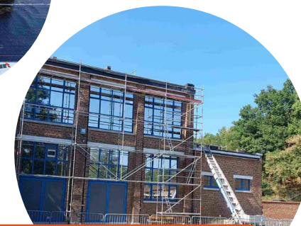
Avant de procéder à l'isolation de la toiture, il a fallu réparer la corniche de l'école des Awirs : un échafaudage a été mis en place pour que les ouvriers puissent travailler en toute sécurité.
