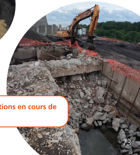
La conduite d'alimentation en gaz a dû être relocalisée.
